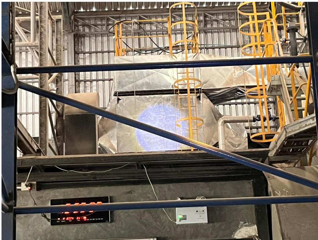
รูปที่ 03 หม้อน้ำขนาด 15 ตันต่อชั่วโมง ซึ่งมีการใช้ไม้สับ (wood chip) เป็นเชื้อเพลิง
