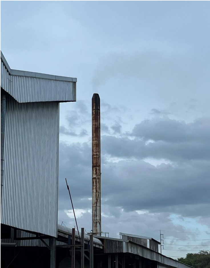
รูปที่ 07 ปล่องระบายอากาศจาก กระบวนการเผาไหม้ของหม้อน้ำหมายเลข 1 ขนาด 15 ตันต่อชั่วโมง ที่มีการนำความร้อน ไปใช้ในกระบวนการอบไม้
