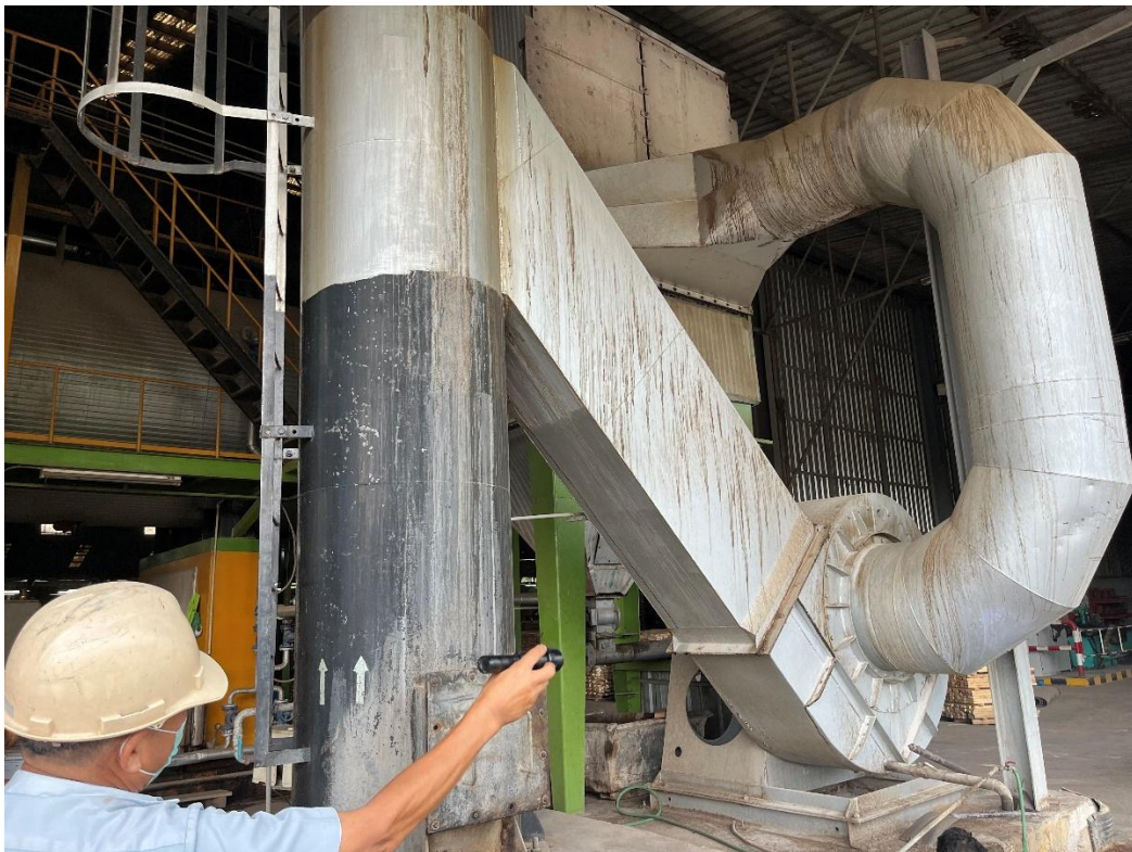
รูปที่ 03 ระบบขจัดมลพิษทางอากาศแบบระบบไซโคลน (Cyclone) ที่ใช้สำหรับหม้อน้ำ 10 ตันต่อชั่วโมง
