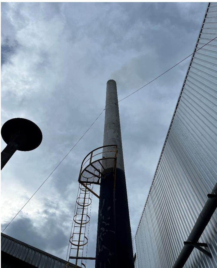
รูปที่ 06 ปล่องระบายอากาศจาก กระบวนการเผาไหม้ของหม้อน้ำหมายเลข 2 ขนาด 10 ตันต่อชั่วโมง ที่มีการนำความร้อน ไปใช้ในกระบวนการอบไม้
