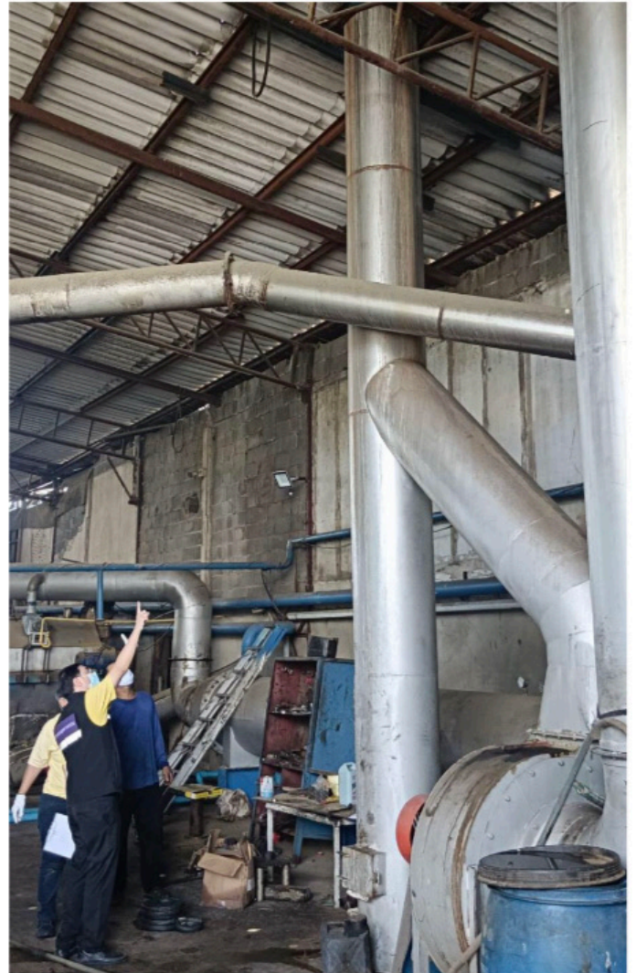
ปล่องระบายของกระบวนการอบไก่อ
