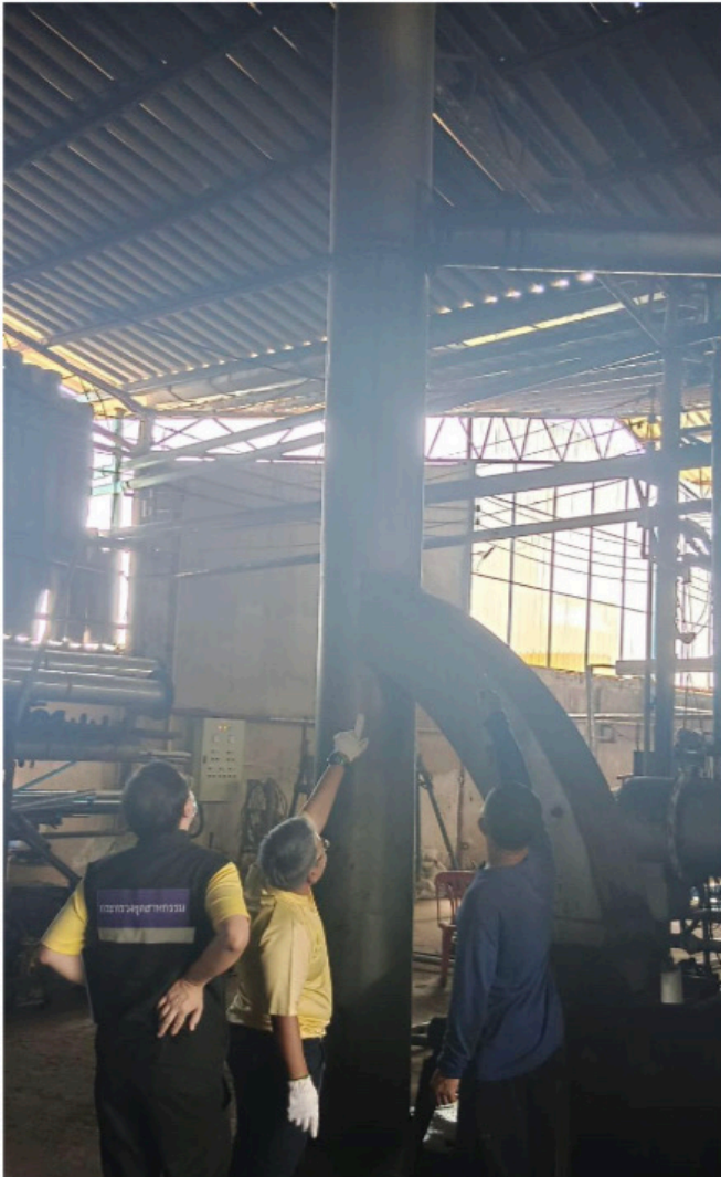
ปล่องระบายของกระบวนการต้มไก่อ
