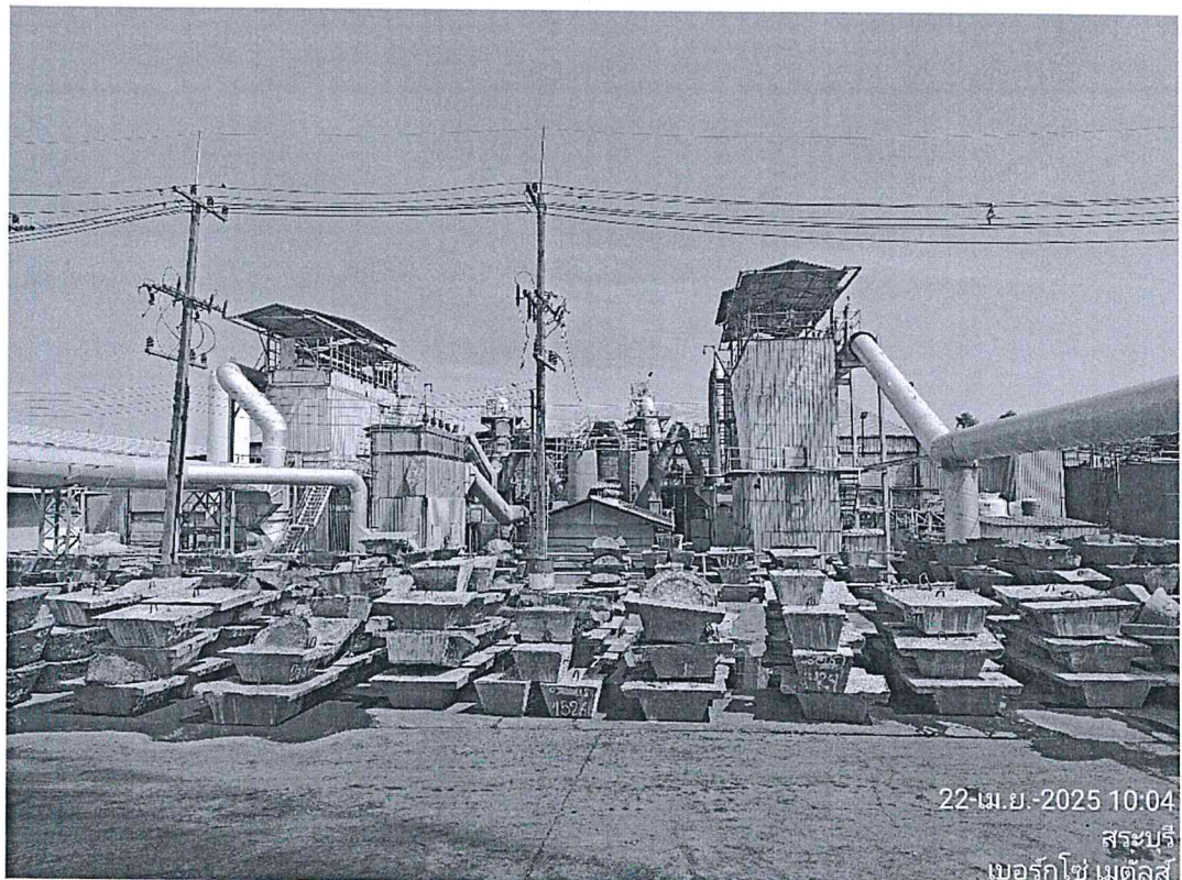
ระบบบำบัดของเตาหลอมอาคาร 1
