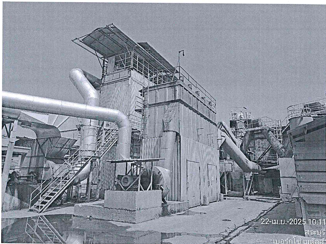
ระบบบำบัดของปล่องระบายจากเตาหลอมอาคาร 1 (โรงกรองอากาศ 7)
